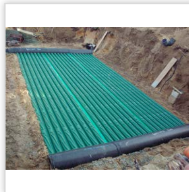
Gruntowy wymiennik ciepła GEOSTRONG – pod płytą fundamentową
